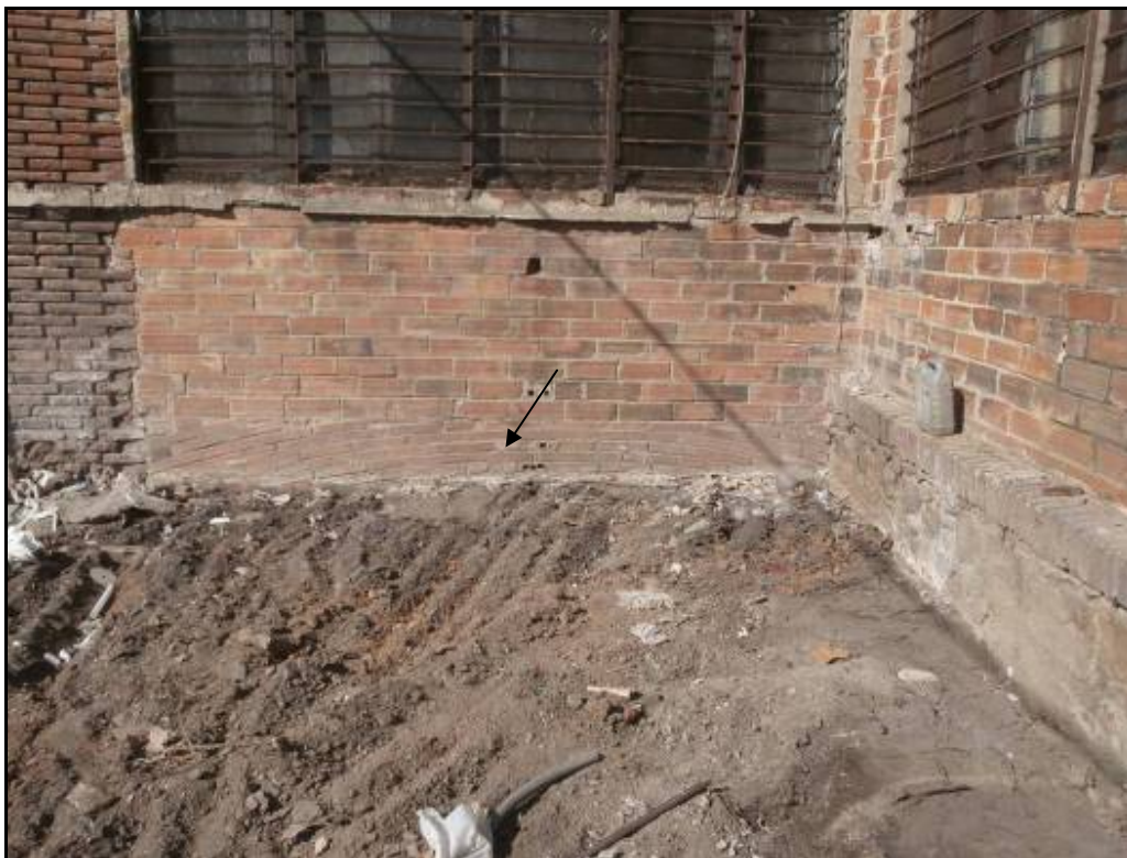
Fotografia 9: Arc de descàrrega a la paret de la finca ubicada a l'extrem oest del solar.
